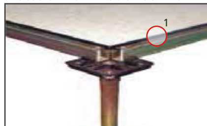
Placas sin terminación de PVC
